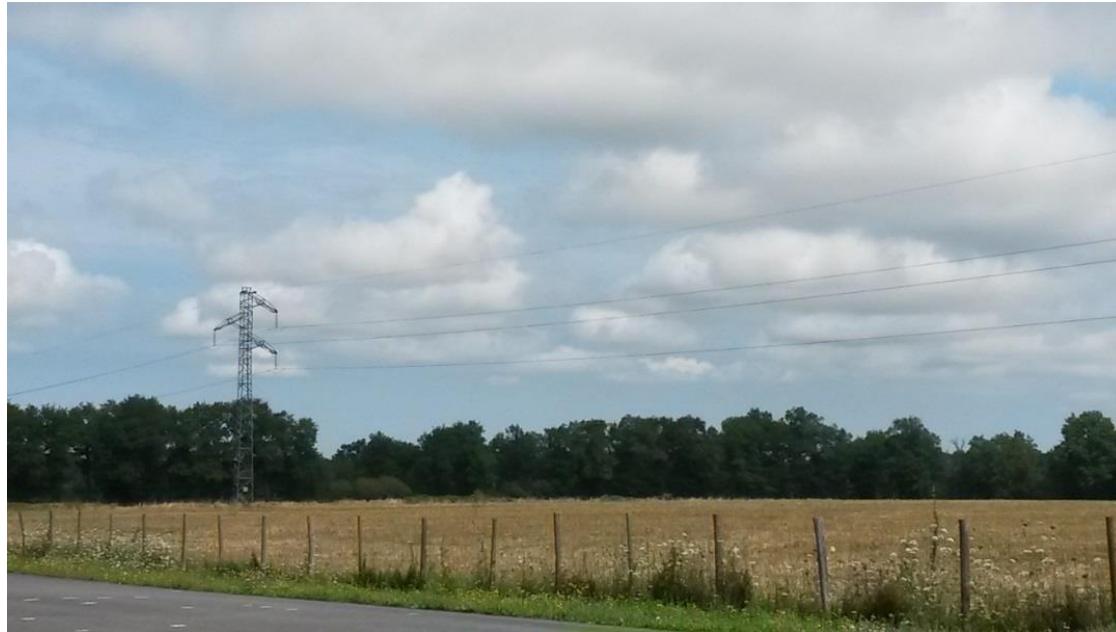
Photo 59 : Ligne haute tension longeant la RN147 au niveau de la section de Berneuil
